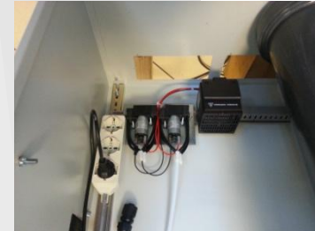
Cablaggio e montaggio unità di riscaldamento
