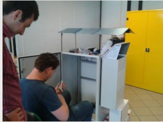
Configurazione Cabinet esterno e unità di raffreddamento
